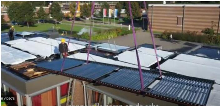
Nagele: zonnecollectoren op dak + warmte-opslag
