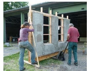
Wanden van stro en leem worden in onderdelen opgebouwd en in 1 dag geplaatst en is dus verplaatsbaar
